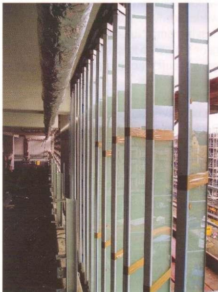
Abb. 2: Schäden infolge zu großer Durchbiegungen, aus [2], sowie verformungsempfindliche Glaslamellen in einem Einkaufszentrum, nachträglich verstärkt durch seitliche U-Profile aus Stahl.
