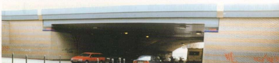
Abb. 1: Überhöhung von etwa 10 cm bei einer Spannweite des Überbaus von ca. 24 m, S-Bahn-Brücke, [5]
